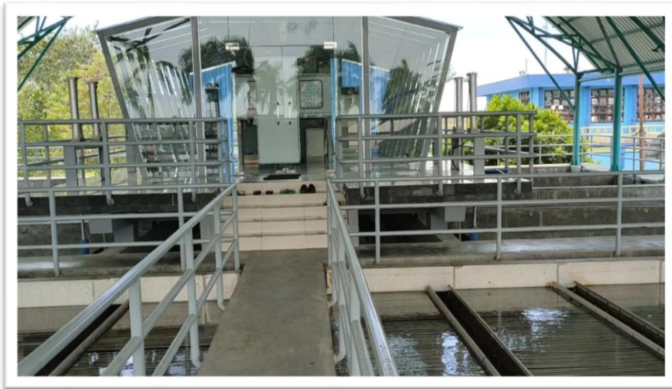
Gambar II - 3 Instalasi Pengolahan Air di PDAM Tirta Khatulistiwa Pontianak
