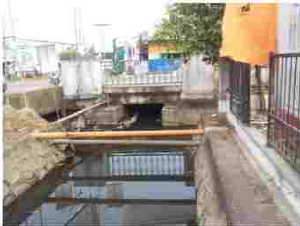
Gambar 3.4. Lokasi Penyempitan Jembatan Simpang Ampera dan M. Yamin.
