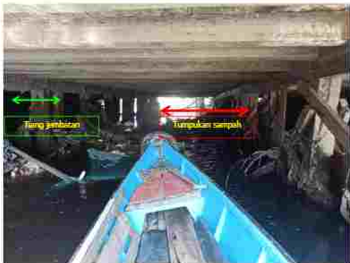
Gambar 3.6. Situasi Parit Tokaya (dibawah jembatan Suez) yang mengalami hambatan aliran akibat tiang jembatan dan tumpukan sampah
