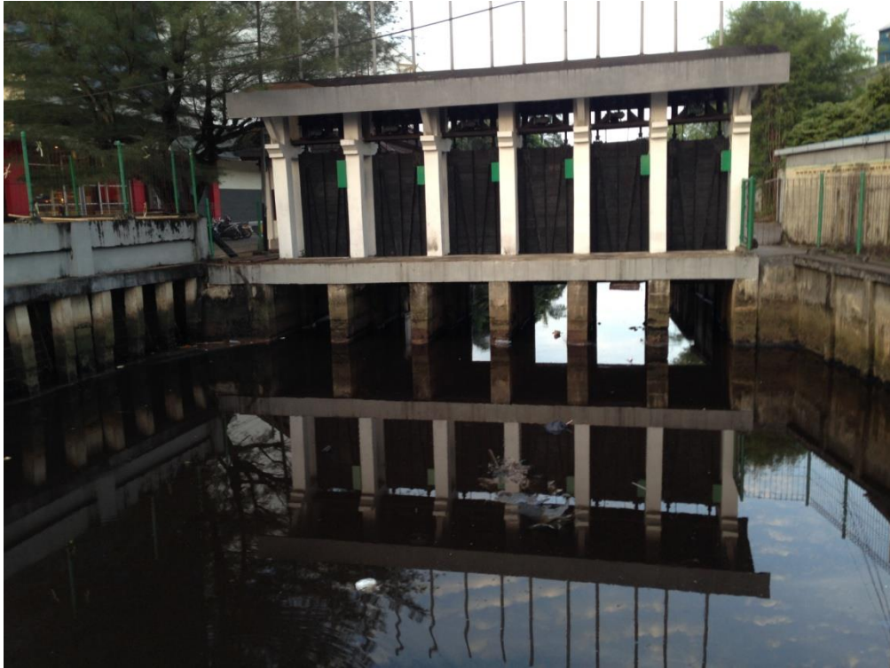
Gambar 5.3 Pintu Air Menuju Sungai Kapuas
