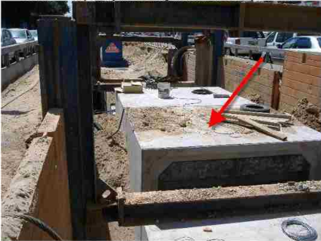
Gambar 2.6. Utility Tunnel (Pabrikasi)
