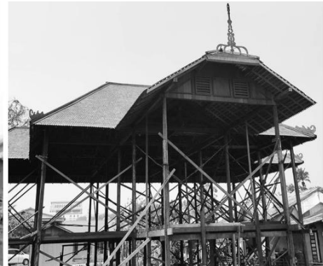
Rumah Tua direkonstruksi menjadi Rumah Budaya Melayu Kota Pontianak di Tahun 2020 Oleh Dinas PUPR Pemkot Pontianak
