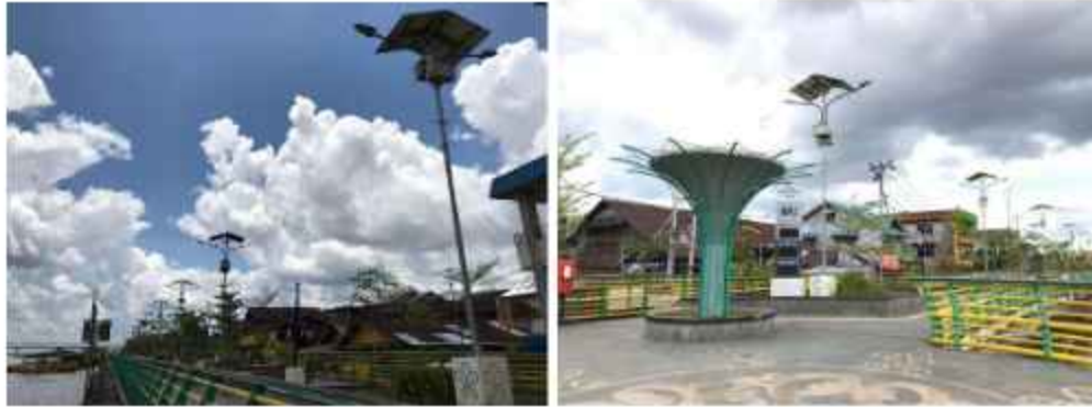
Gambar 3.12. Kondisi Jaringan Listrik
