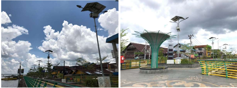
Gambar 3.12. Kondisi Jaringan Listrik
